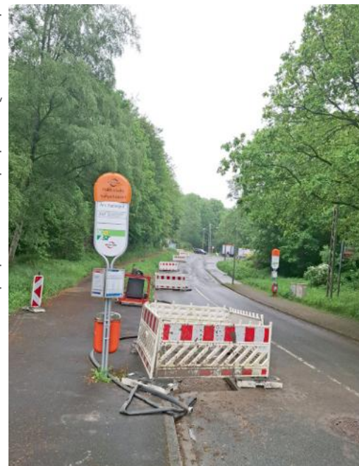
Die Hasenwinkeler Straße ist wegen zahlreicher Bohrlöcher noch länger gesperrt.
