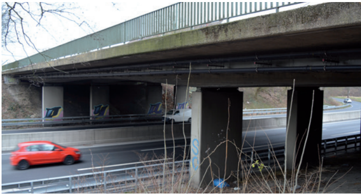
Muss abgerissen werden: Die Brücke über dem Sheffieldring.
