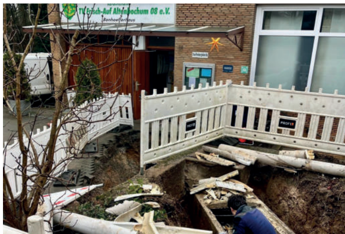
Hier liegt das Problem: Die alten Heizungsrohre müssen komplett erneuert werden.
