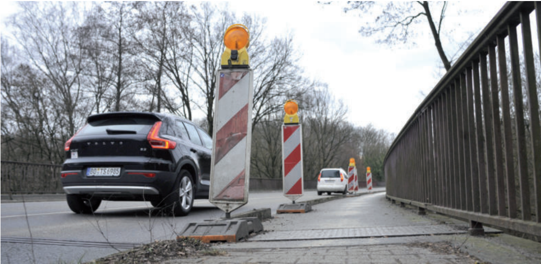
Die Brücke entspricht nicht mehr den Sicherheitsvorgaben.
